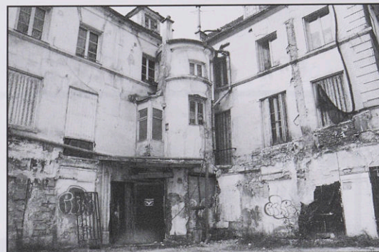
La façade dans son lamentable état actuel.
