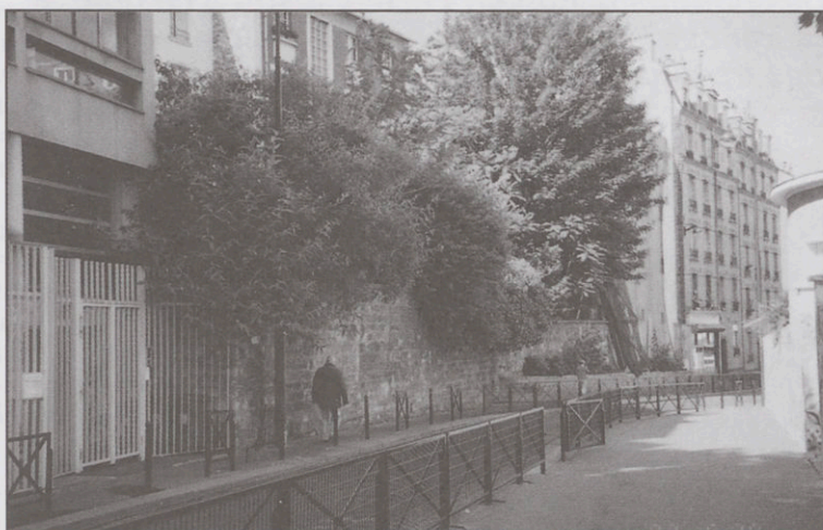
Au premier plan à gauche, la grille d'entrée de la crèche Polonceau, puis le mur de pierre, avec au fond le "muret-jardinière", qui est un des points faisant problème dans la rue.
