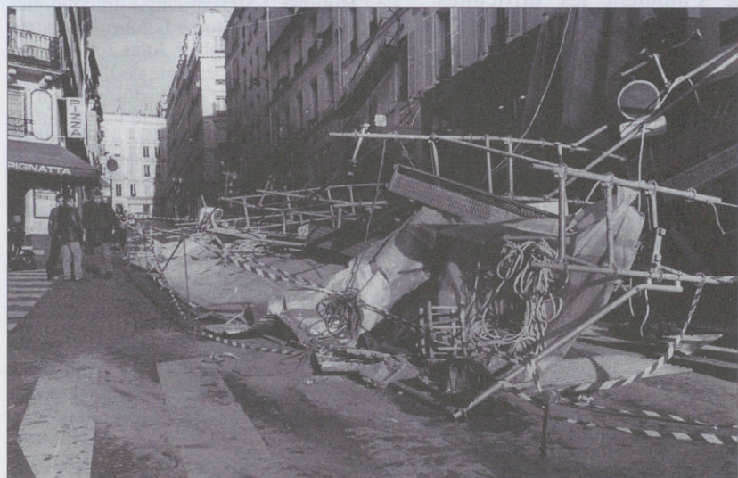
Rue des Martyrs, le vent a fait s'effondrer cet échafaudage.
